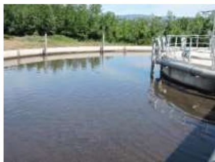
Station d'épuration de Pertuis
